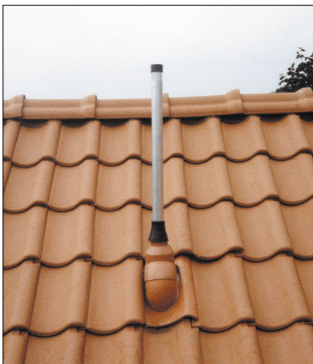
Bild 03: Setzen Sie die vier fehlenden Dachziegel wieder ein.
